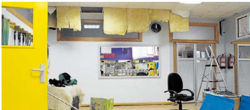
En el gimnasio Aerogin, de la calle Hormilleja, la lluvia llegó a caer en cortinas a través del techo. E. G. M.
