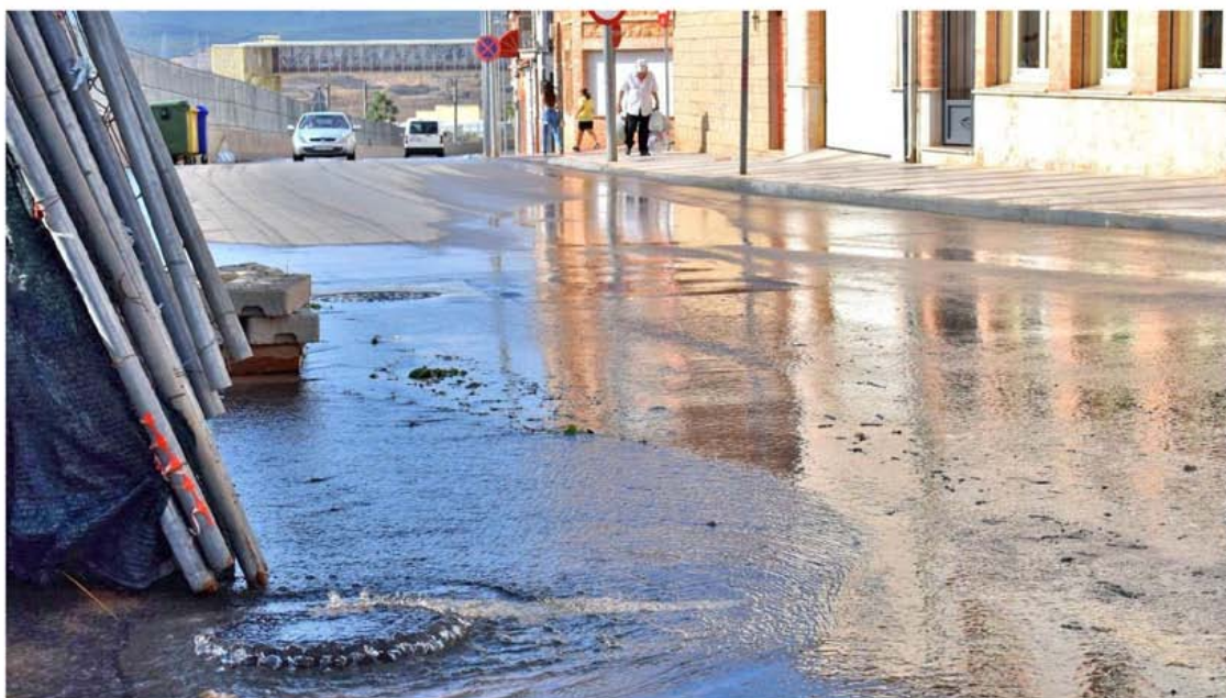
Avería en Puertollano
